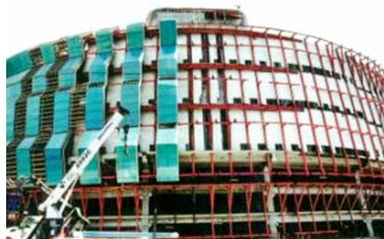
Mặt tiền cửa hàng bách hóa Liverpool tại thành phố Mexico City
